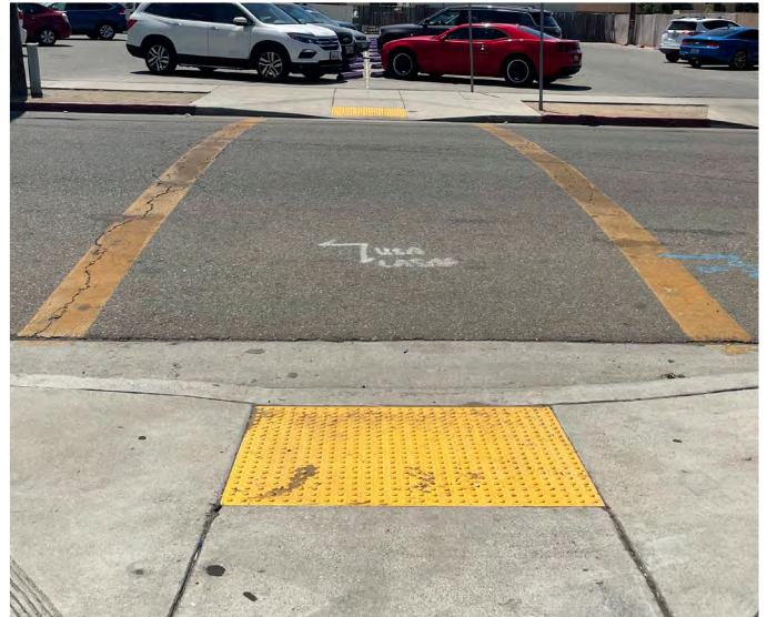
ARRIBA: El cruce peatonal amarillo que conecta la entrada de la Escuela Secundaria Yosemite con el estacionamiento está muy desgastada.
