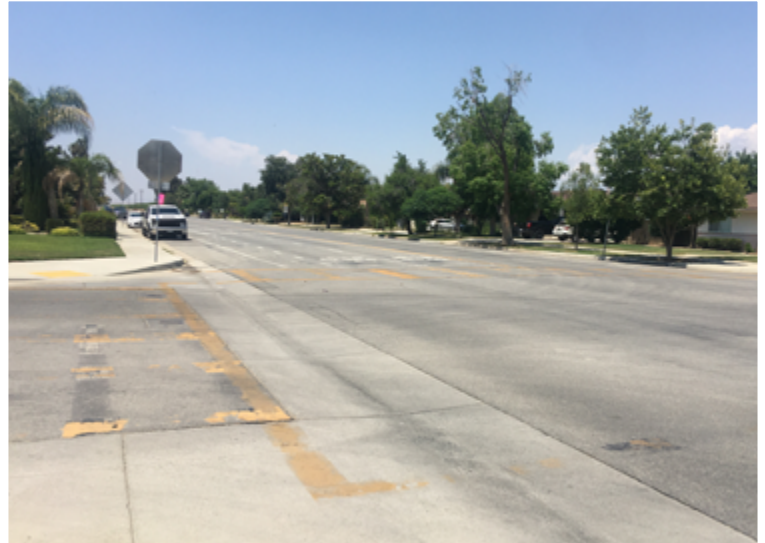
ARRIBA: Los cruces peatonales de alta visibilidad en Paseo Grapevine y Paseo Campus están casi completamente descoloridos.
